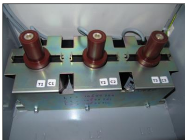
Конусы типа А Автоматический выключатель 200А включают трансформаторы тока
