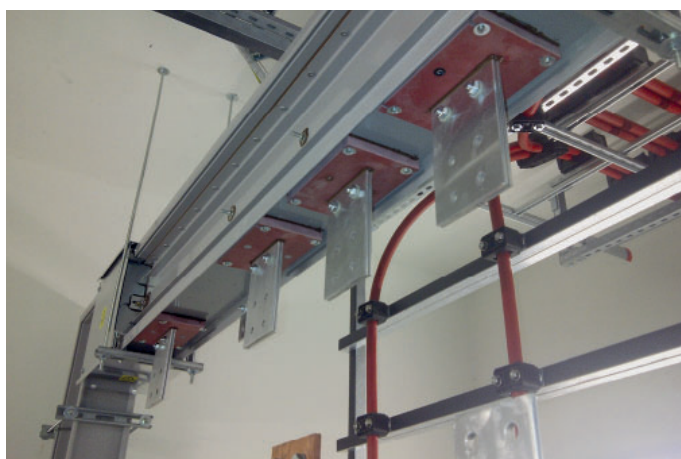
Предприятие пищевой промышленности Aveb, Тер-Апелканал, Нидерланды Шинопровод с алюминиевыми проводниками Power Xpert® XP 2500 А, подключение к трансформатору
