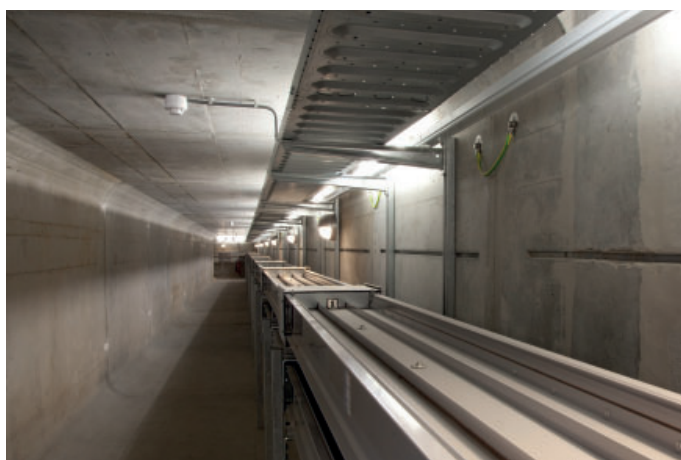
ЦОД Galvano Techniek, Хенгело, Нидерланды Соединение силового трансформатора с распределительным щитом через шинопроводы Power Xpert® XP (с алюминиевыми проводниками) 1600 А, 3200 А, 4000 А
