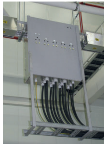
К центральной вводной секции подводится несколько кабельных линий
